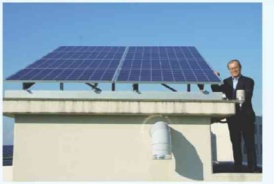
太陽光・風力発電設備の外観
